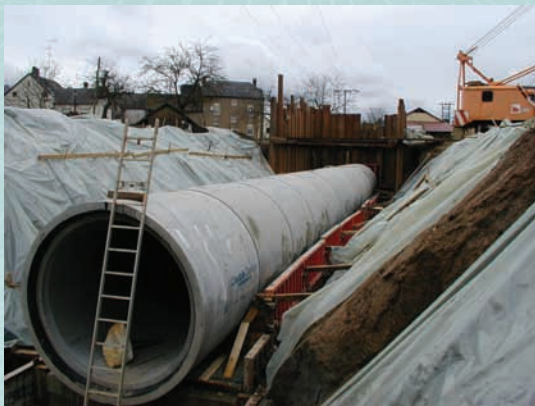
Kanalstauraum DB 5.02 Olingen
