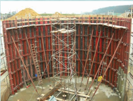
Kläranlage, Mitteltrichter Kombibecken
