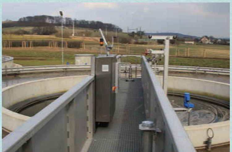
Kläranlage, Mitteltrichter Kombibecken
