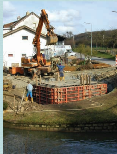
Fangbecken FB 6.01 Olingen
